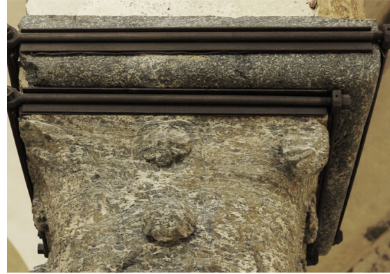
25. Capitello à crochet , ecclesia interior , fine del XIII secolo-primotrentennio del XIV, già chiesa di San Francesco, oggi palazzo San Francesco, Domodossola
