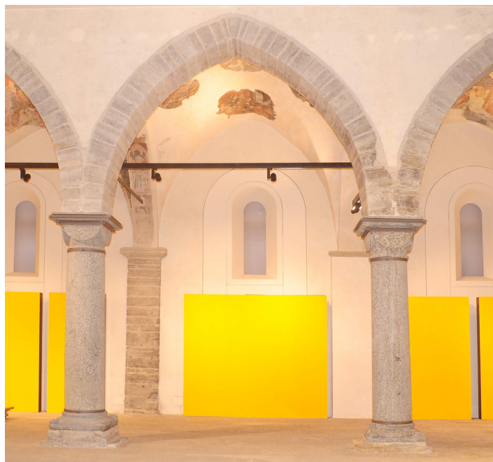
10. Campata laterale, ecclesia exterior , fine del XIII secolo-primo trentennio del XIV, già chiesa di San Francesco, oggi palazzo San Francesco, Domodossola
